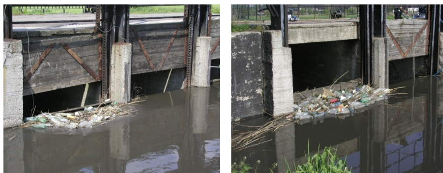
Rys. 1. Zanieczyszczenia gromadzące się powyżej zamknięć jazów Fig. 1. Debris accumulating under weirs gates
