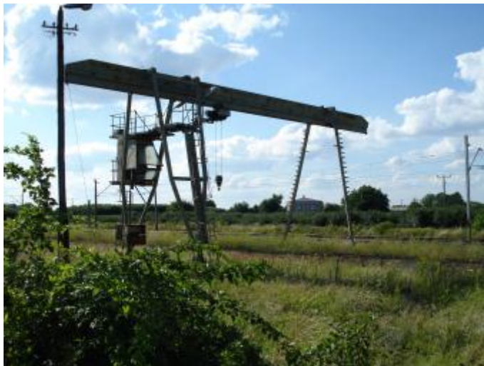
Rys. 2. Urządzenia przeładunkowe na stacji Nałęczów (fot. M. Iwanek) Fig. 2. Special installation for trans-shipment of railways station Nałęczów (photo by M. Iwanek)
