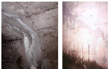
Fot. 5. Sztolnia przed remontem – widoczne pęknięcia, ubytki oraz zacieki z soli na powierzchni ścian
