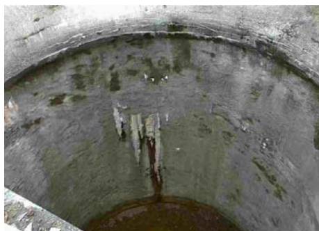
Fot. 1. Wnętrze wieży przelewowej przed remontem. Widoczne ubytki oraz zacieki z soli na powierzchni ścian
