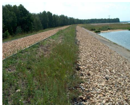
Fot. 8. Widok ekranu i korony zapory bocznej nr 1 po naprawie Phot. 8. View of lateral dam shield and crest after repair works
