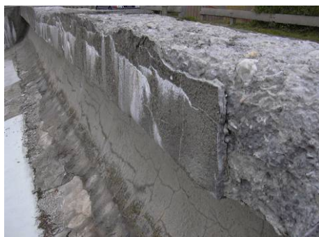
Fot. 3. Falochron przed remontem – widoczna zniszczona głowica falochronu
